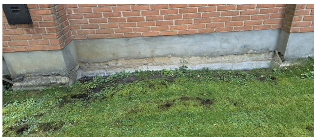
Revner i sokkel · Porøs fuge ved vindue
